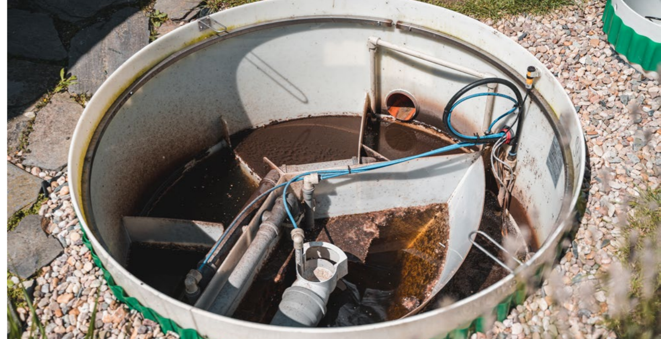
Domácích čistíren odpadních vod stále přibývá.
