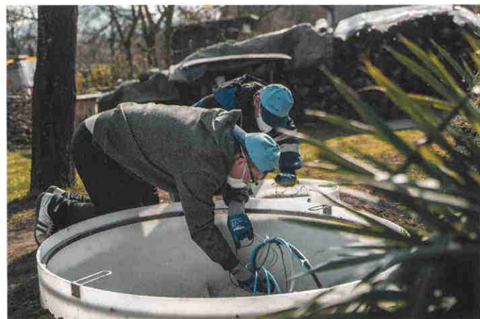
Instalace telemetrie do domovní ČOV
