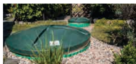
DČOV s technologickým boxem
