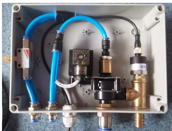
Rozváděč vzduchování - analogové čidlo
