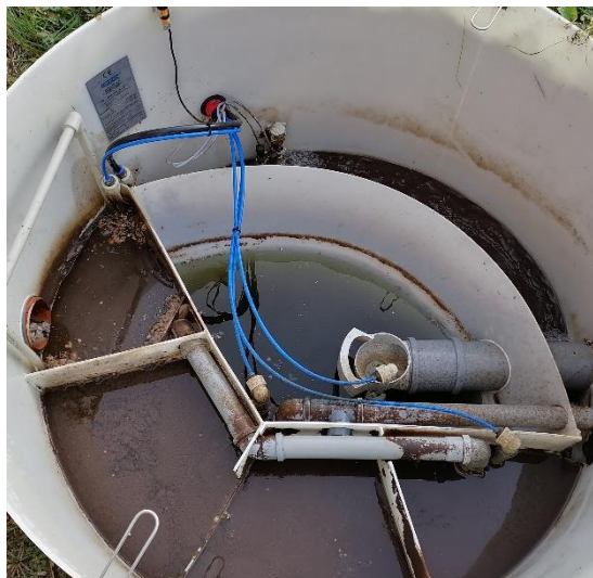
Příklad umístění kalového čidla v ČOV
